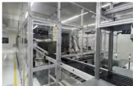
全自动上下料隧道炉
