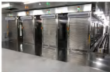
可参观式隧道线老化房
